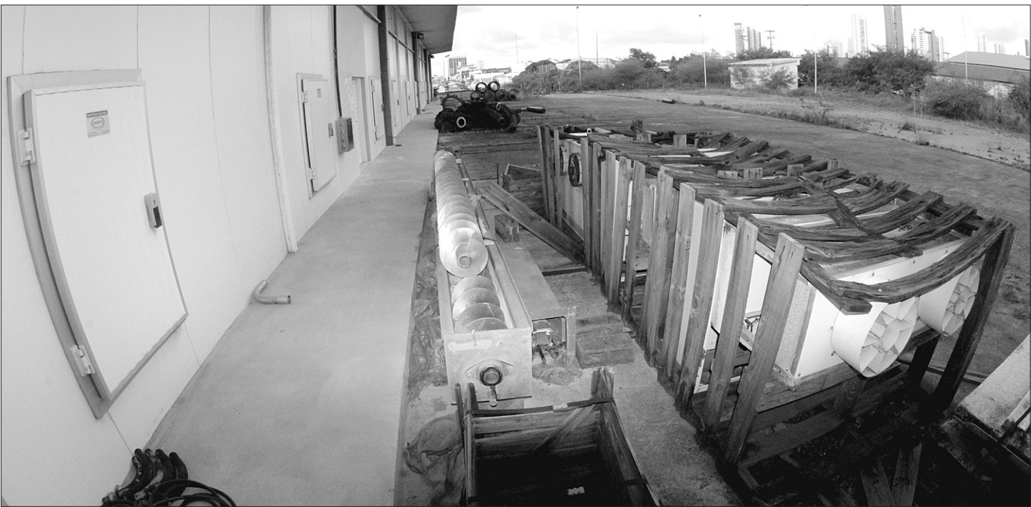
Uma das obras citadas no relatório é o Terminal Pesqueiro, na zona Leste de Natal, que está há cinco anos com obras paralisadas
